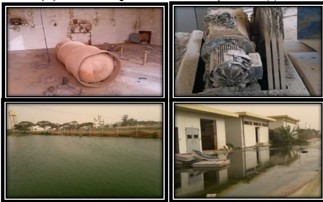
صورة (6) أثار الصدى في معدات محطة المعالجة والطفح مياه الصرف الصحي في المحطة.
