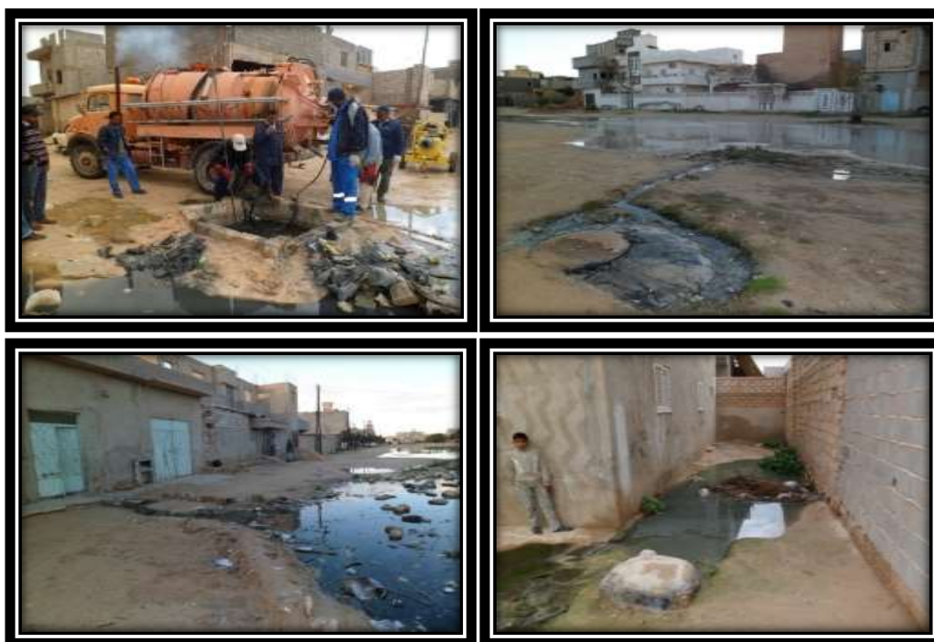
صورة (7) انسداد غرف التفتيش لشبكة الصرف الصحي بالملوثات الصلبة والطفح السطحي لمياه الصرف الصحي المنزلي في شوارع حي الأدغال.
