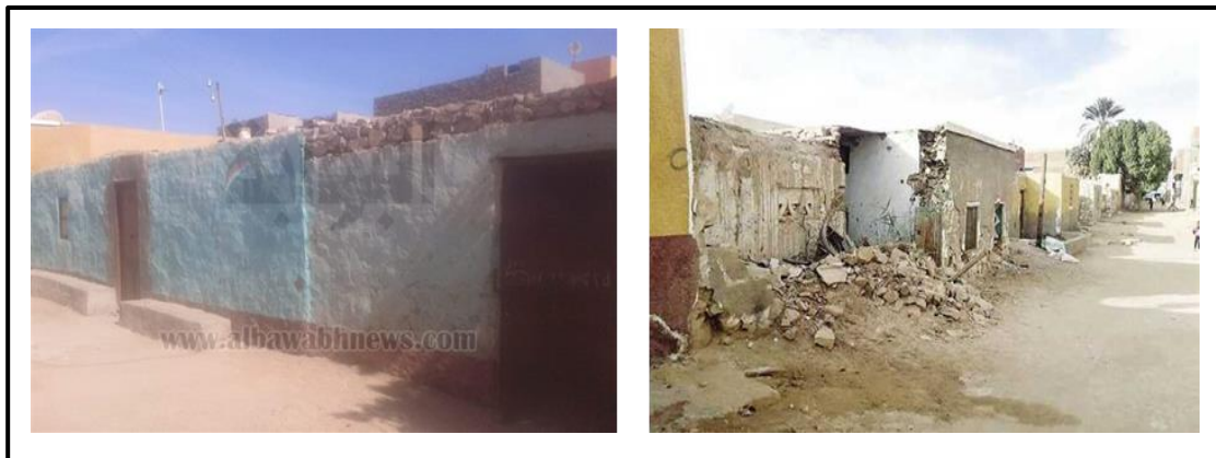
صورة (3) نموذجان من المباني ذات الطابق الواحد في قرية المنشية لاحظ تدهم بعض المباني وعدم رصف الشوارع
